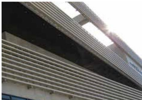
Connecta Plaza - Terranum Cielorraso punzonado Bogotá - Cundinamarca
